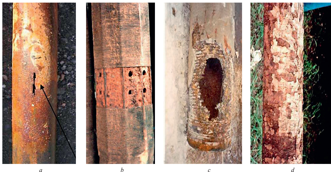
Рис. 2. Коррозионные повреждения водоподъемных и фильтровых труб
