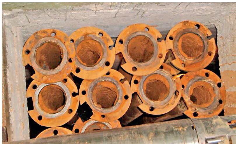
Рис. 4. Осадки на внутренних поверхностях водопроводных труб
